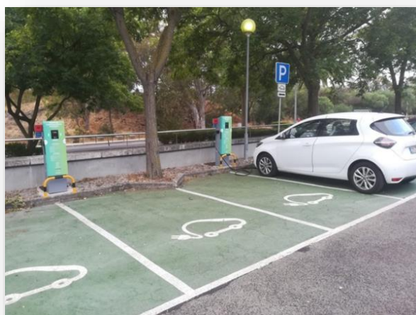
Figura 24 - Entrada em operação dos carregadores de mobilidade elétrica do parque de Carcavelos
